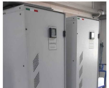
Armoires électriques sur site industriel Ouagadougou
