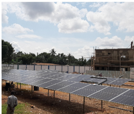
Implémentation d'un champ solaire à la CNSS Bangui (RCA)
