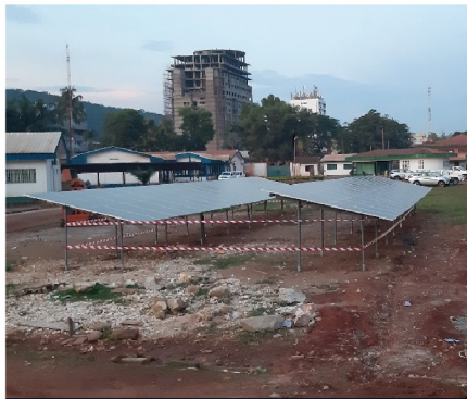
Installation d'un système solaire en autoconsommation 30KWc en Centrafrique
